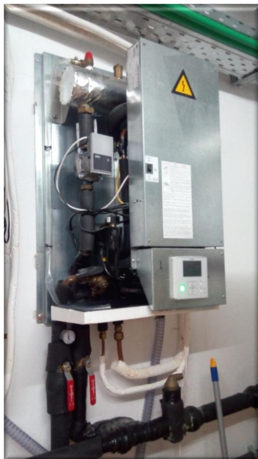
Εικόνα 11: Συστήματα Η/Μ σε κατοικία στο Ν. Καβάλας
