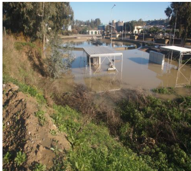
Εικόνα 4-11: Κατάκλυση εγκαταστάσεων ΒΙΟΚΑ
