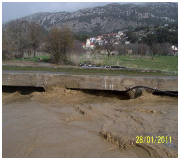
Εικόνα 4-9: Ανύψωση στάθμης νερού σε τεχνικό
